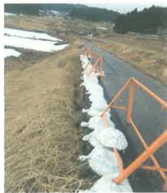
同年9月再度崩れで応急措置
