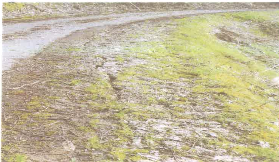
⑧市道論田中央線路肩、亀裂、下がり 新
