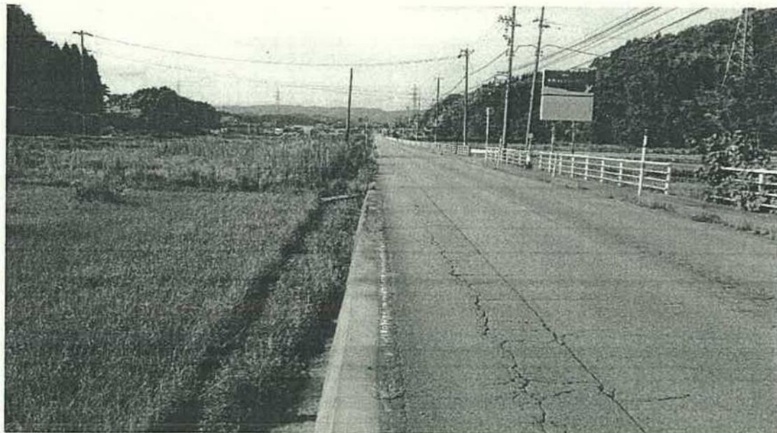
現状の路肩整備の状態
