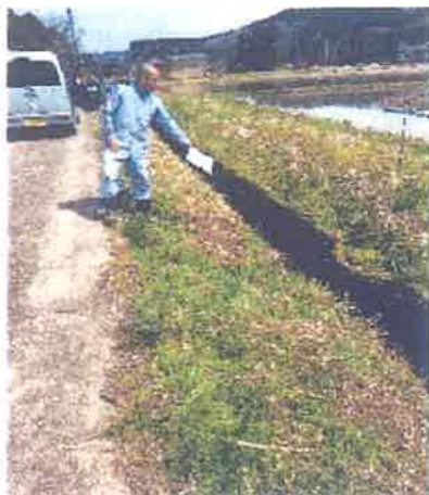
④ 地震で割れ。市道の路肩が下がった。
