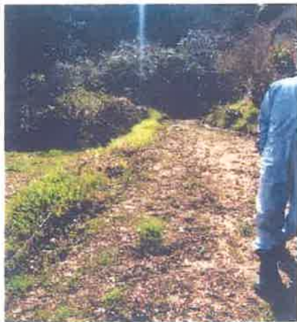
① 土砂崩れ 一部自力で修復破損（継続要望）
