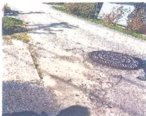
⑥ 地震で市道陥没
