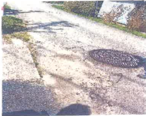
⑥ 地震で市道陥没
