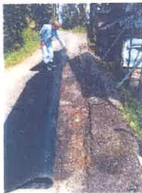
⑦ 地震で市道陥没。下部に住宅あり。
