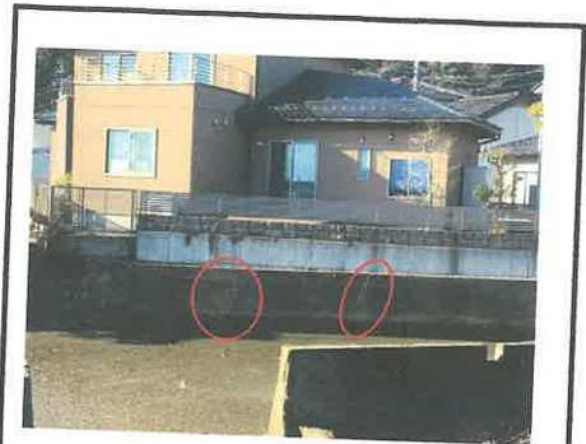
⑭ 垂姫川河口護岸亀裂(数か所) 1月15日、治山治水担当に連絡済
