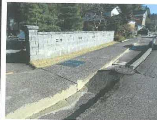
⑰ 長さ約250m、深さ最大30cmに渡って歩道陥没
