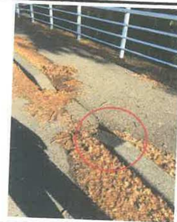
⑰ 市道縁石陥没
