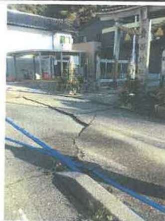
⑯ 垂姫神社前道路亀裂
