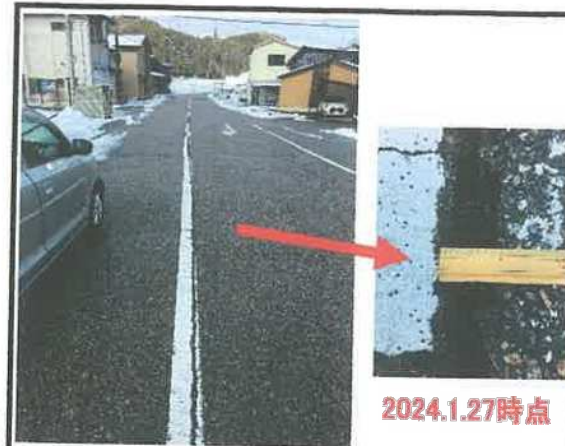
② 藪田交差点より市道側道路 中央亀裂(約5cm幅)
