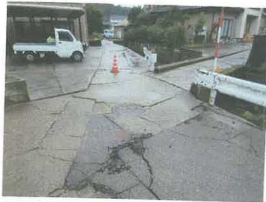
⑮ 道路亀裂、マンホール隆起
