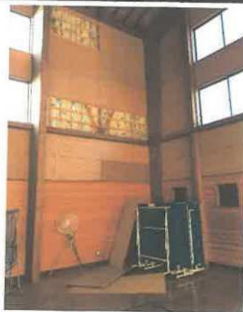
① コミュニティセンター屋内 パネル板5枚落下 壁損壊
