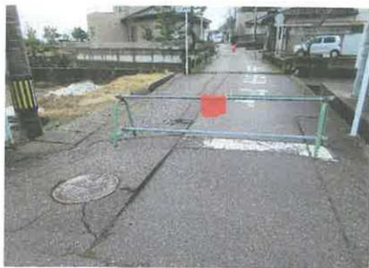
③ マンホール亀裂
