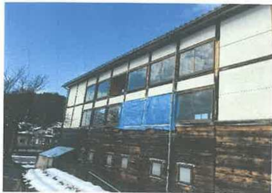
① コミュニティセンター屋外 7枚ガラス破損
