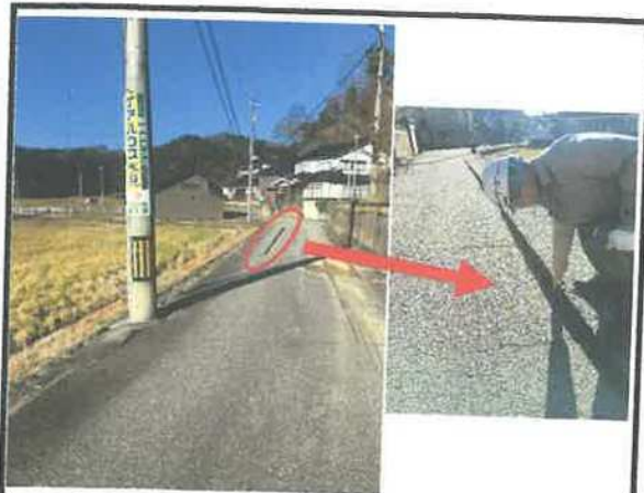
⑫ 道路亀裂(段差)と液状化
