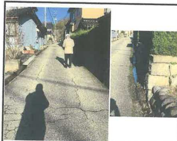
⑤ 道路亀裂 側溝隆起
