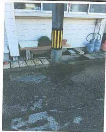
⑥ 液状化、電柱傾斜 (北陸電力送配電へ連絡済)
