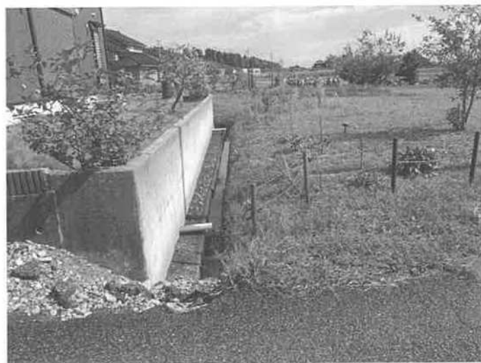
宅うしろの排水路。暗きょ閉塞によってこの排水路に水が逆流して入り込み、右側の畑が水につかる。
