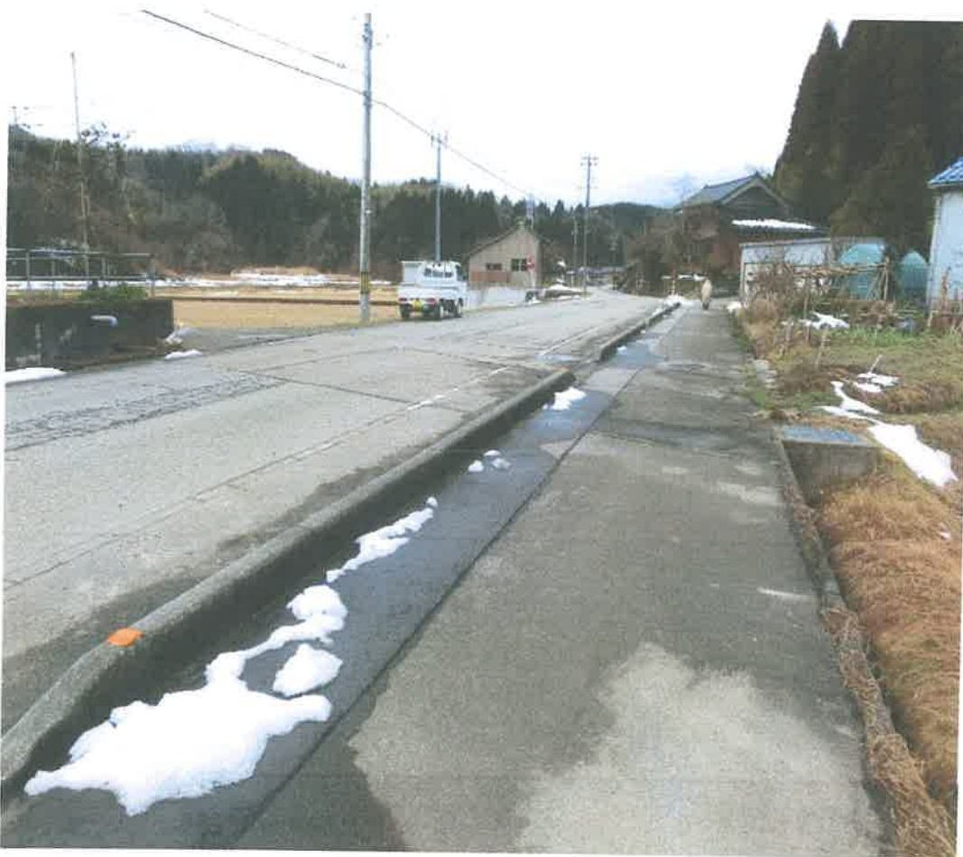
用水路暗渠BOX-500×400
