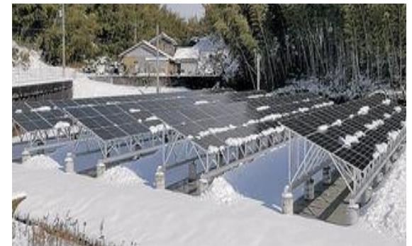
上泉地内未利用地での太陽光発電設備
