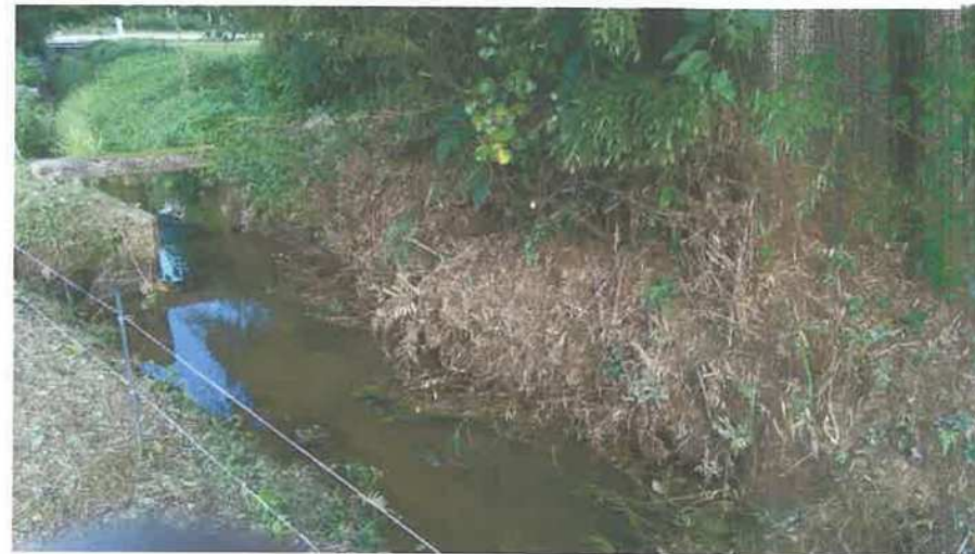
令和 4年 9月 25日 撮影 五郎平水門付近の崩壊法面 上流から
