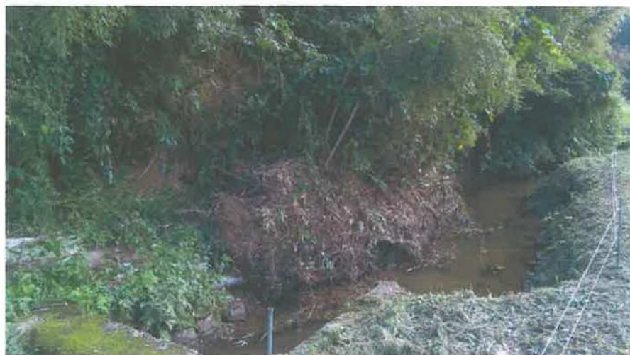
令和 4年 9月 25日 撮影 五郎平水門付近の崩壊法面 下流から
