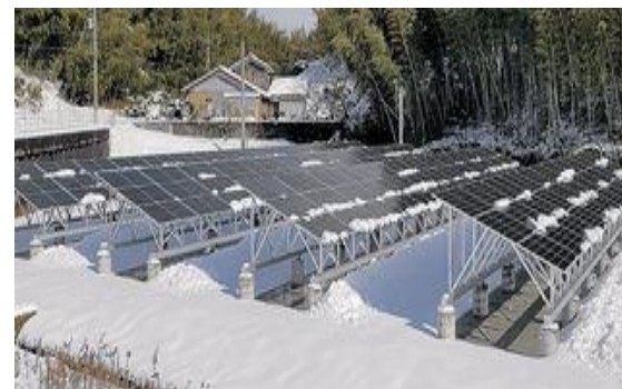
上泉地内未利用地での太陽光発電設備
