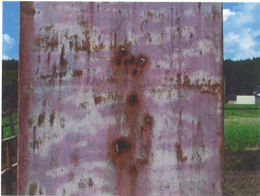
水門枠現況（穴）
