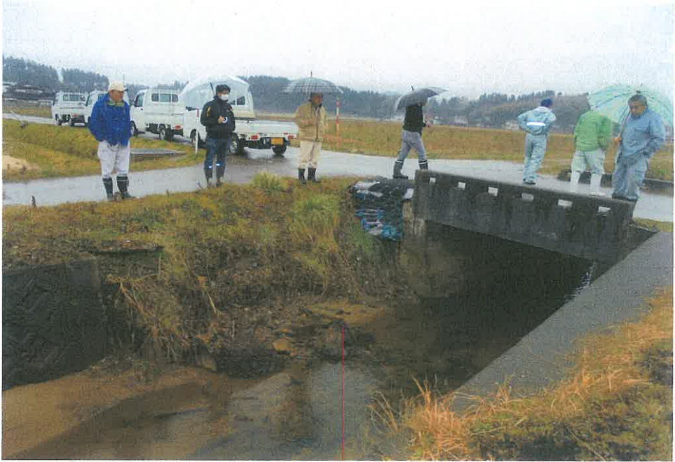
堀田川河岸の崩落 (市道と堀田川交差点)
