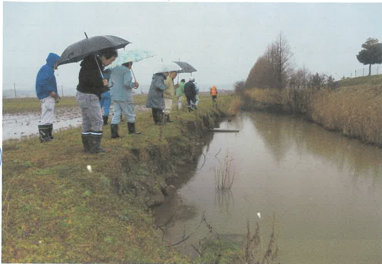
パークゴルフ場横 水溜まりによる農道路肩崩落
