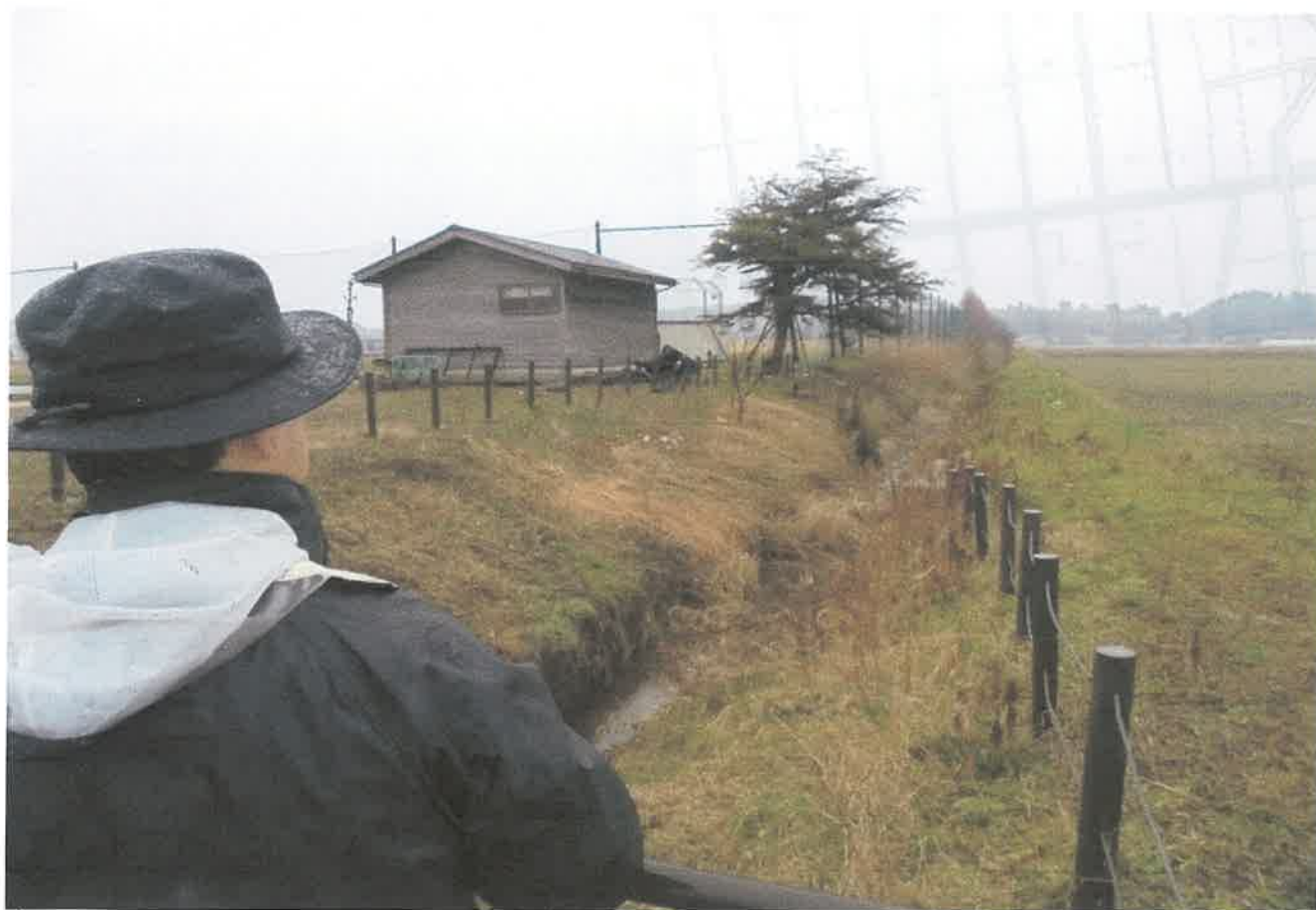
軽運動道場横排水路 詰まり
