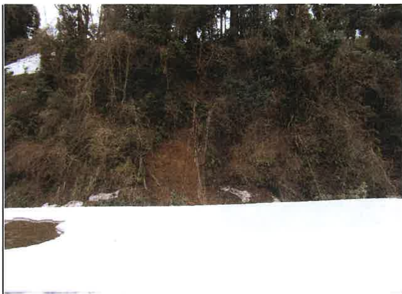
要望事項－② 崩落箇所全景
