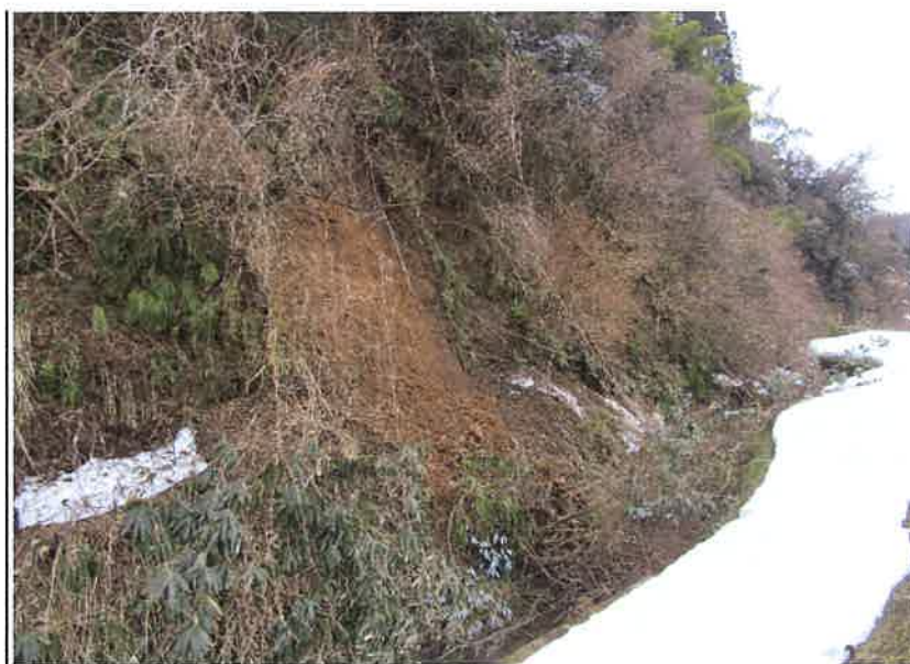
要望事項－② 崩落箇所(下流側)
