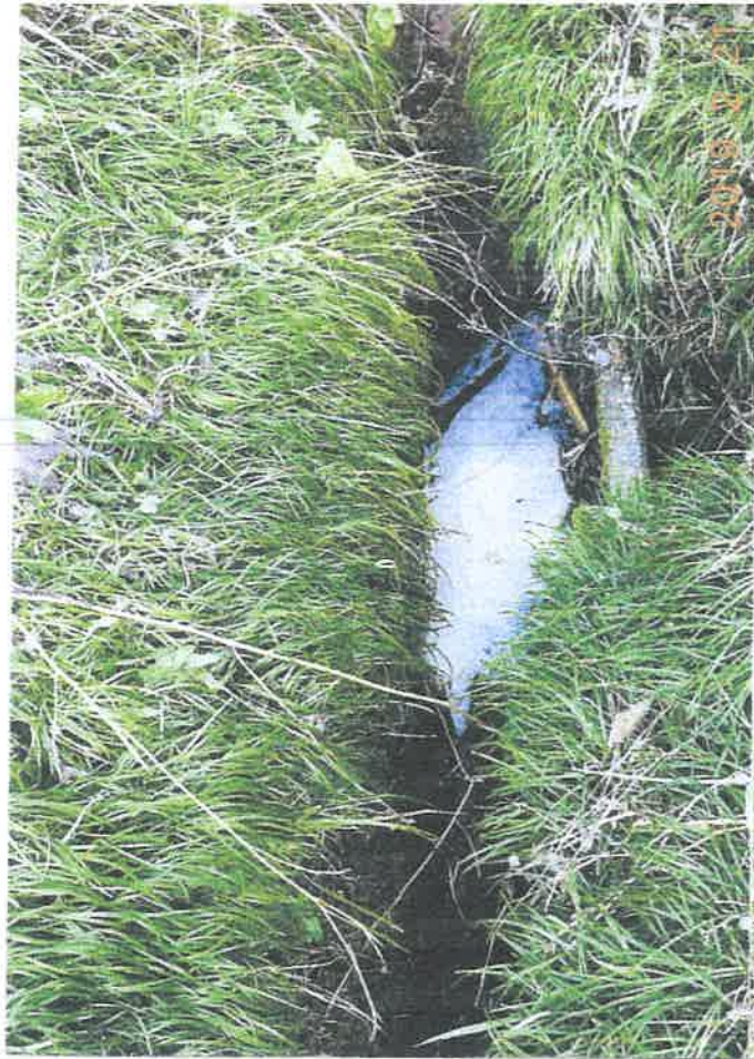
东锡地区 生活用水路U字溝破损
