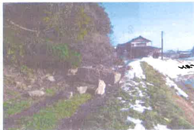
②平成 29 年 1 月 27 日崩落
