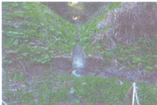
市道側溝に流れ込む状況
