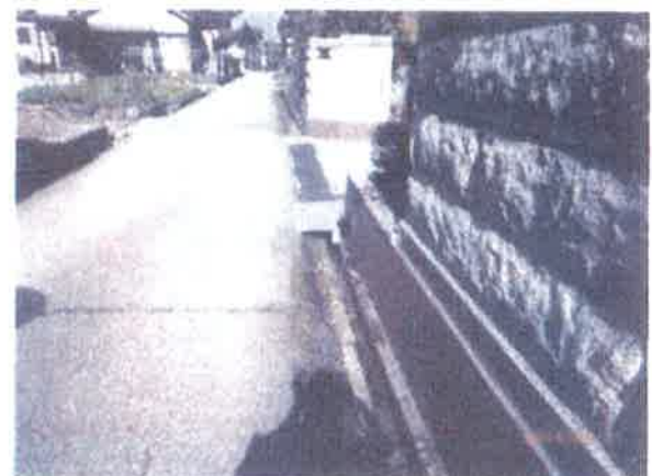
⑧ 側溝と車道路肩部分が滑りやすく危険（転倒事例有）
